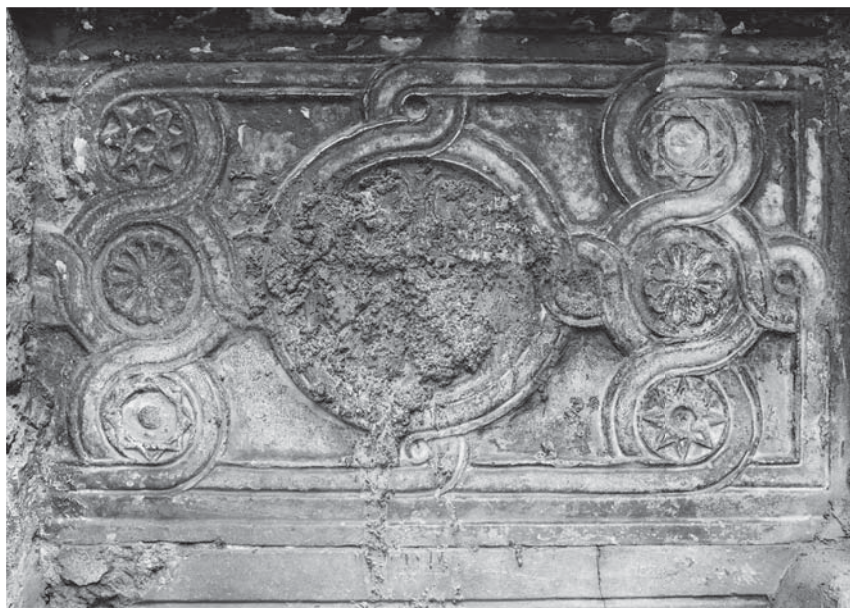
Fig. 3a - Vefa Kilise Camii, esterno, lato sud della facciata dell'esonartece, lastra settentrionale.
